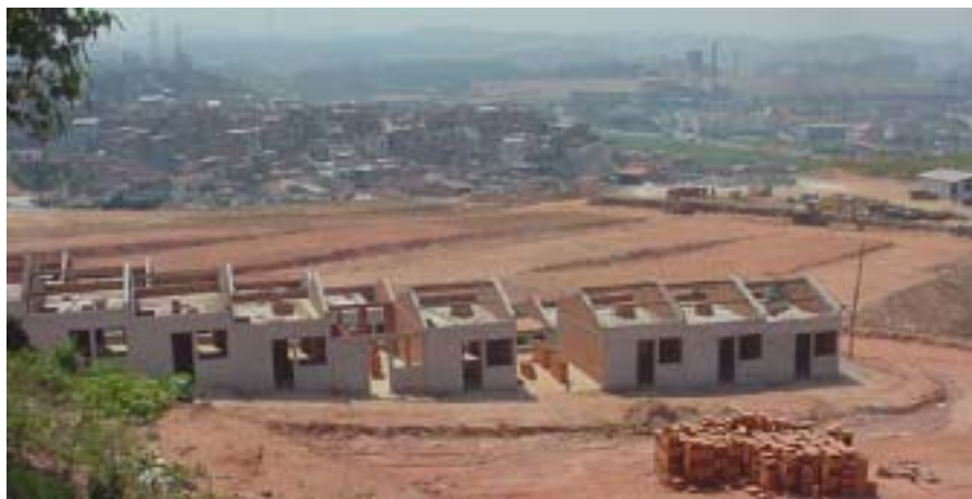
foto 120. Conjunto Habitacional Alzira Franco: reassentamento que abrigará as famílias removidas dos núcleos Gamboa e Capuava Unida
