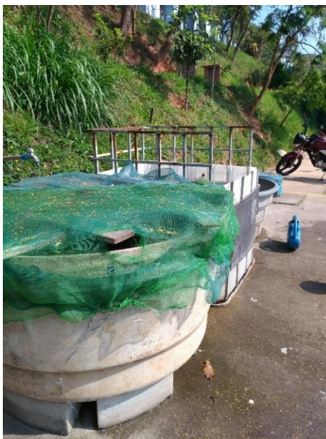
Figura 9 - Tanques que captam água da nascente
